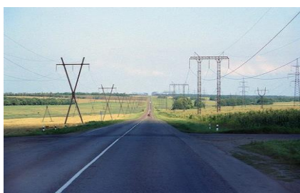
Рис. 114. Линии электропередач Кураховской ГРЭС
