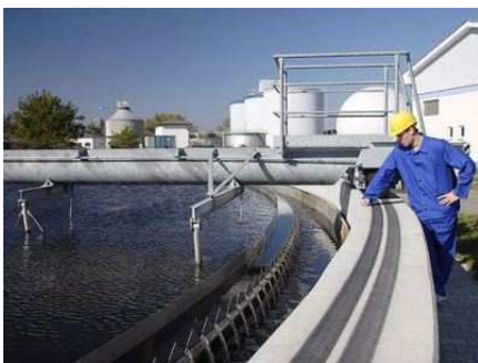
Рис. Станция очищения воды
