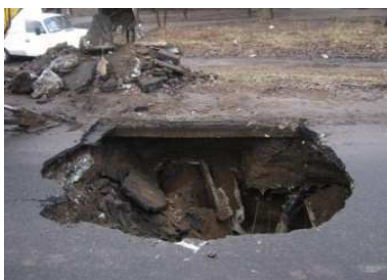
Рис Провал грунта
